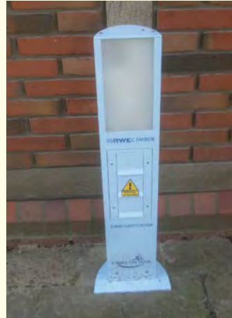
E-Bike-Ladestation an der Remise des Heimathauses
